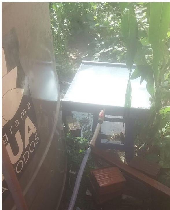
Figura 06 – Aqualuz implantado para realização dos testes em Croatá, São Gonçalo do Amarante.
