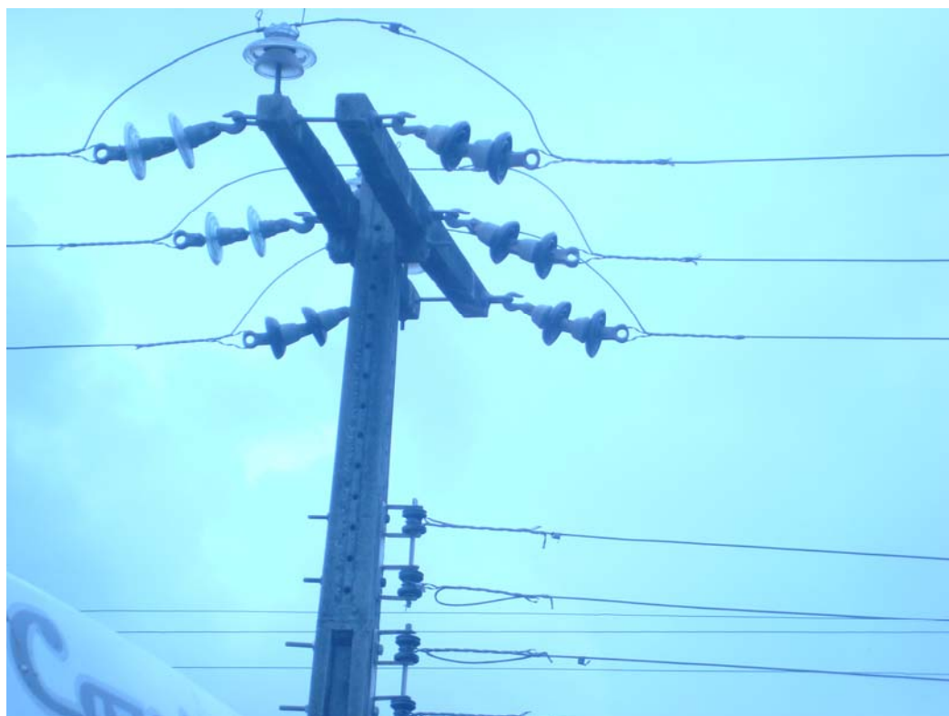
Figura 4.15 - Isoladores tipo disco, pino (multicorpo) e roldana no poste do centro de treinamento (foto do autor).
