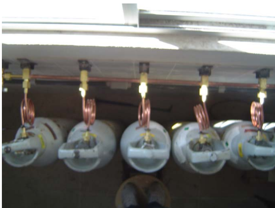
Figura 3.22 - Vista superior da conexão entre os cilindros e o MANIFOLD (foto do autor).
