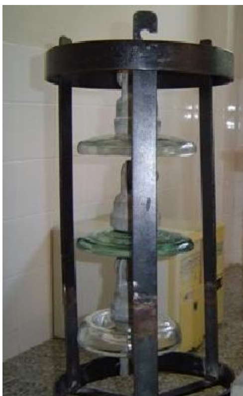
Figura 3.25 - Estrutura de sustentação para a cadeia de isoladores (foto do autor).
