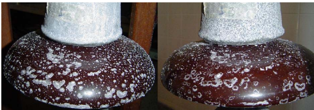
Figura 3.27 - Comparação da condição do isolador antes e após a limpeza com gás nitrogênio (foto do autor).
