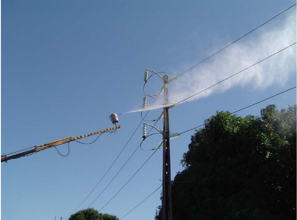
Figura 1.2 - Sistema convencional de lavagem em funcionamento.
