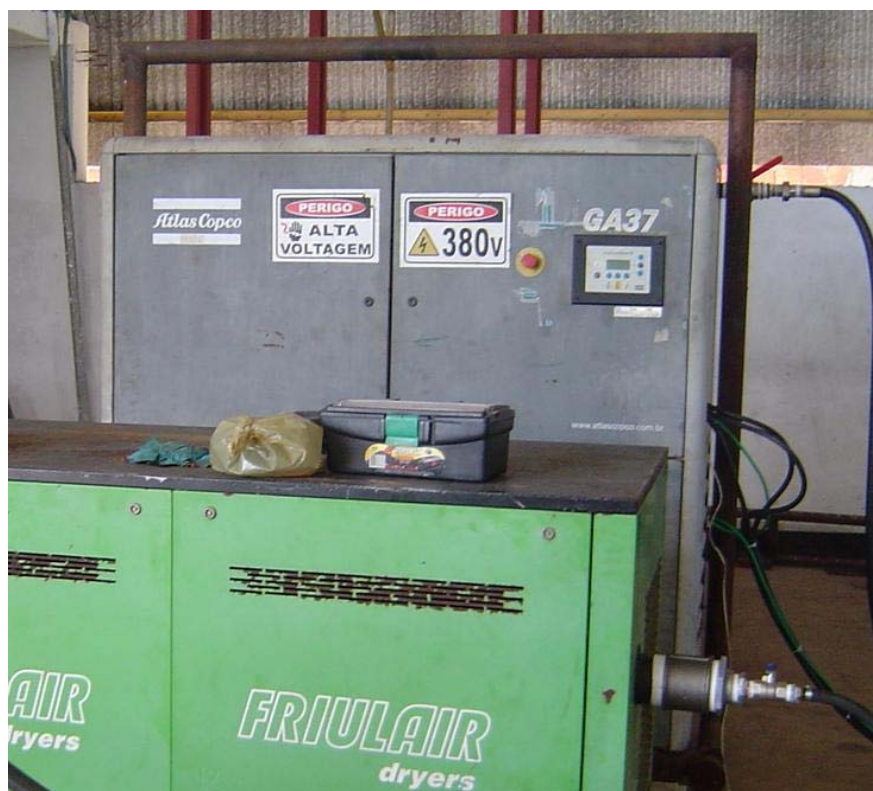
Figura 3.32 - Compressor GA 37 e secador de ar (foto do autor).
