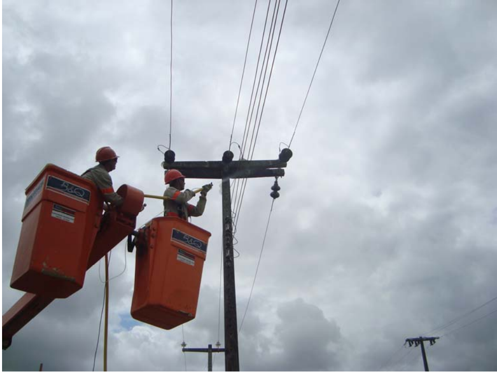
Figura 4.16 - Limpeza das cadeias de isoladores tipo disco de porcelana (foto do autor).
