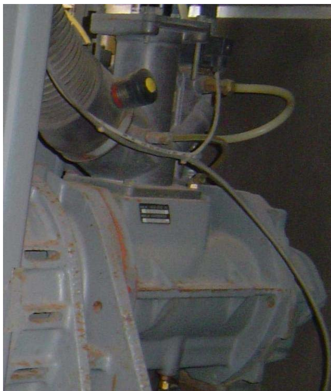
Figura 3.34 - Elemento compressor do GA 37 (foto do autor).
