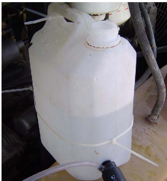
Figura 3.62 - Recipiente que armazena a água usada no processo MPA (foto do autor).
