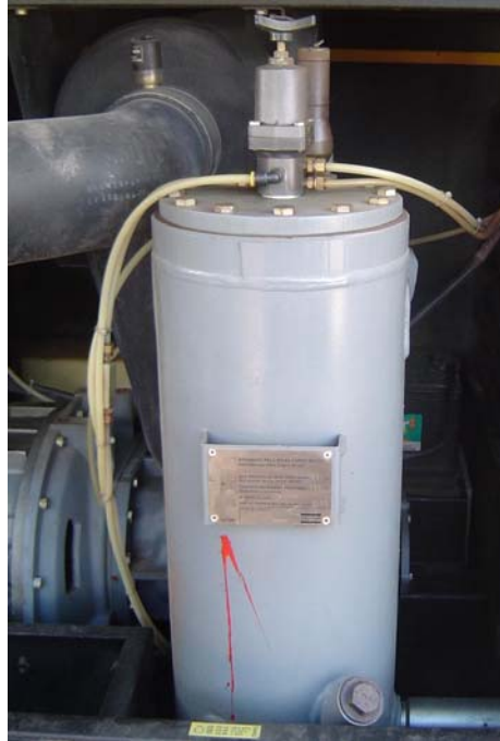
Figura 3.49 - Reservatório de ar do XATS 176 (foto do autor).
