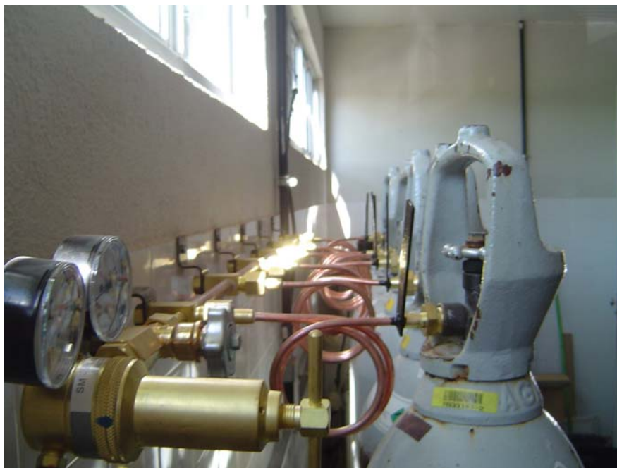
Figura 3.21 - Vista lateral da conexão entre os cilindros e o MANIFOLD (foto do autor).
