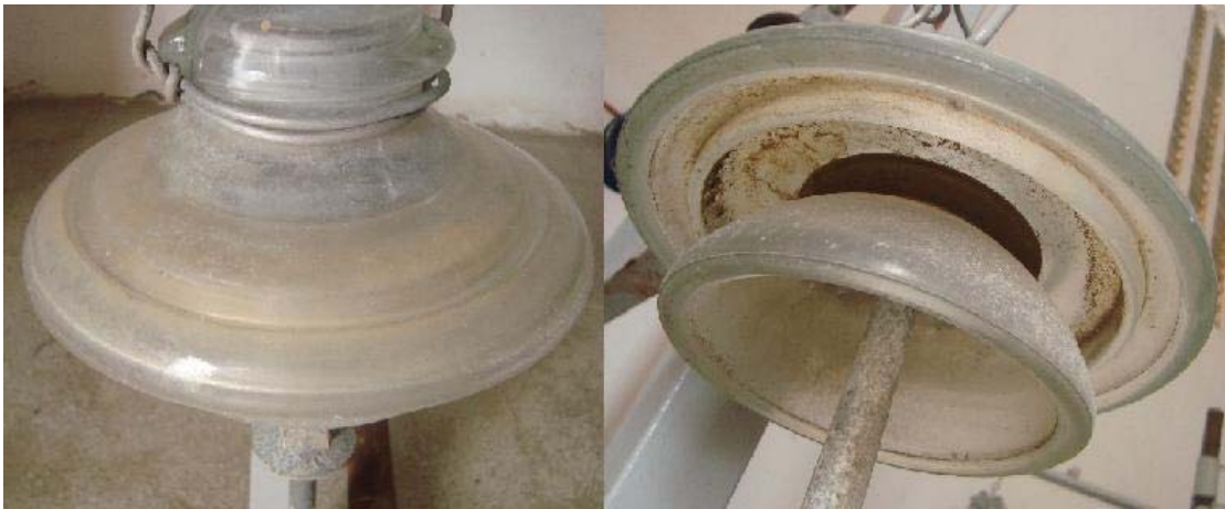
Figura 4.20 - Isolador de pino multicorpo 1 (foto do autor).
