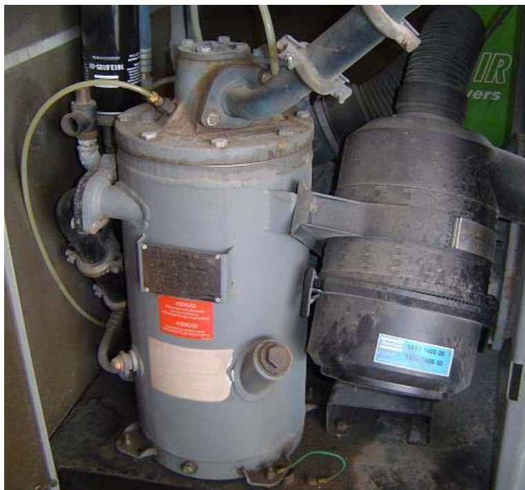
Figura 3.33 - Reservatório e filtro de ar do compressor GA 37 (foto do autor).
