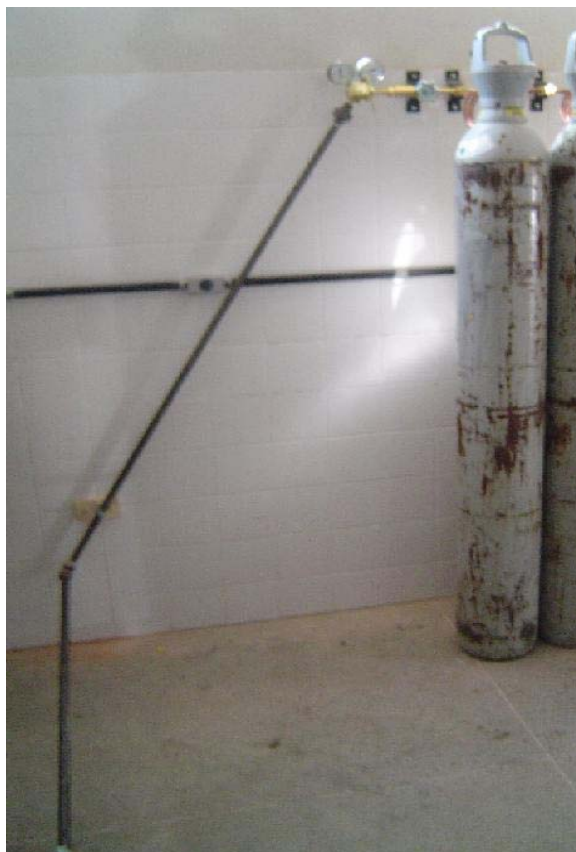
Figura 3.26 – Circuito de canos que conecta a saída do cilindro com a serpentina flexível (foto do autor).
