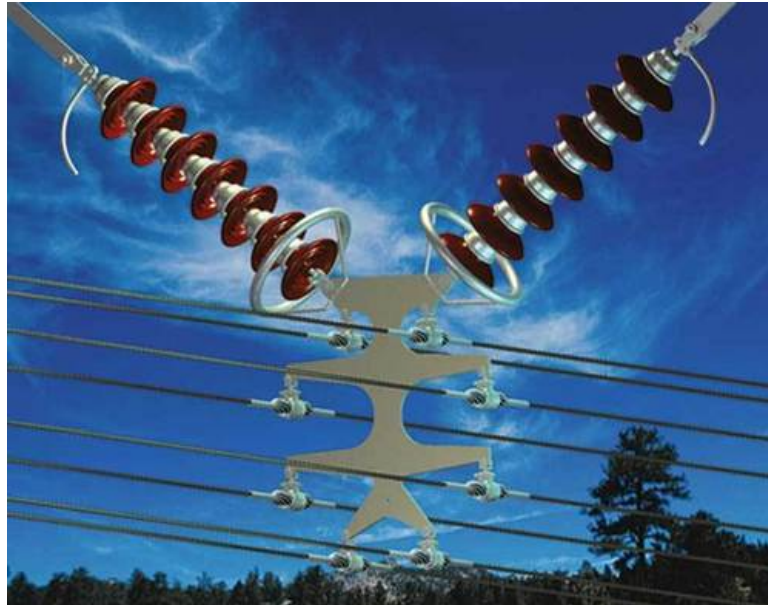
Figura A.28 - Cadenas de isoladores em suspensão em "V" [25].
