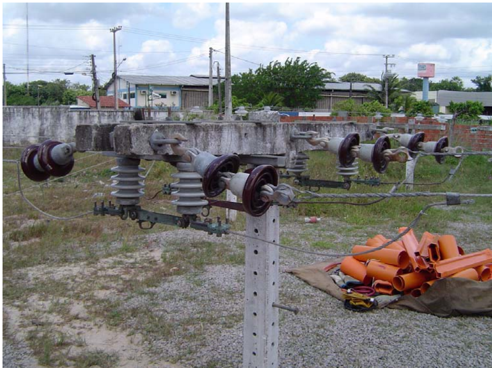
Figura 4.1 - Postes de altura reduzida do centro de treinamento da B&Q Eletrificação (foto do autor).
