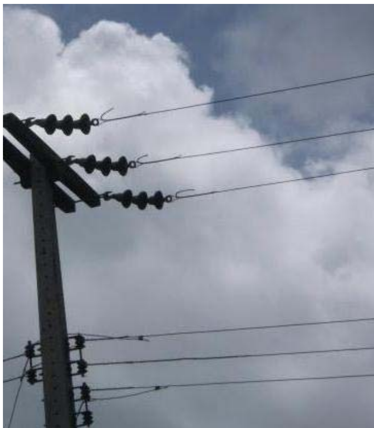
Figura 4.27 – Estrutura de uma linha de distribuição de 13,8 kV (foto do autor).
