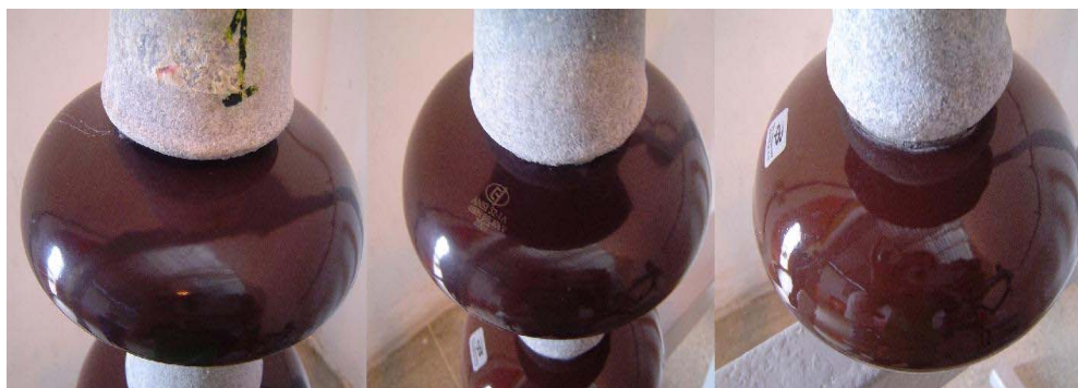
Figura 3.61 - Cadeia de isoladores após a limpeza com ar comprimido e aplicação do procedimento MPA (foto do autor).
