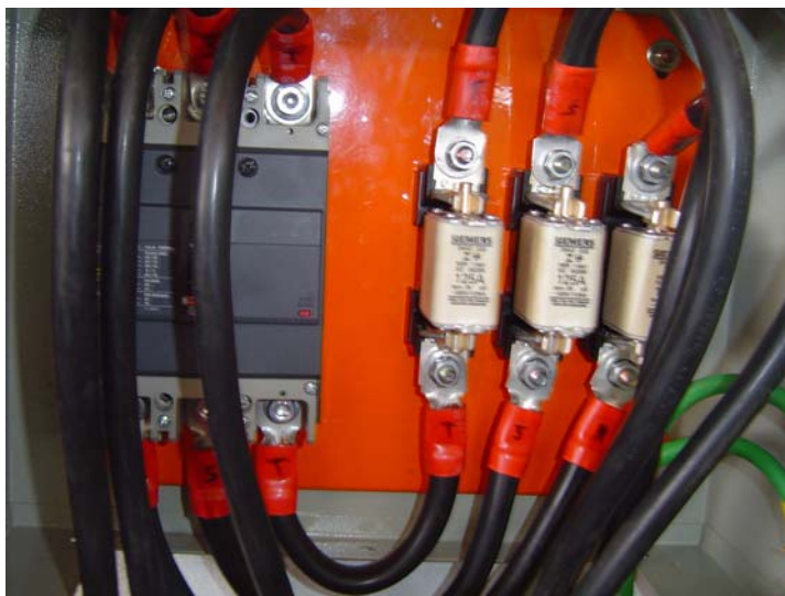
Figura 3.37 - Quadro de força para a alimentação do motor (foto do autor).
