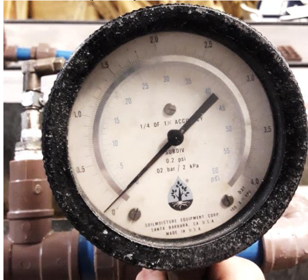
Figura 24 - Aferição da pressão manométrica na saída do filtro
