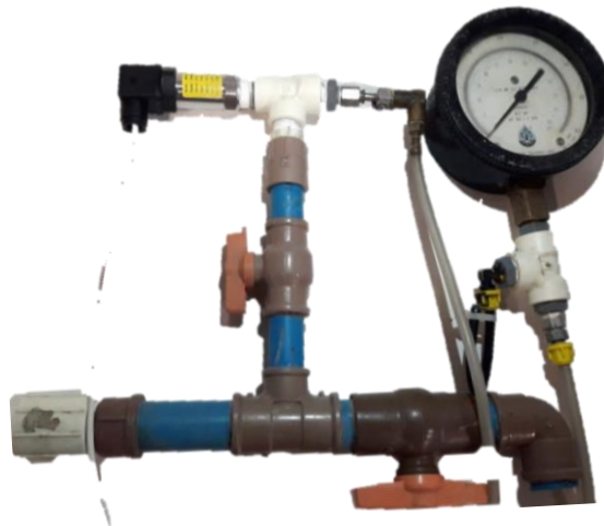
Figura 26 - Estrutura hidráulica para calibração
