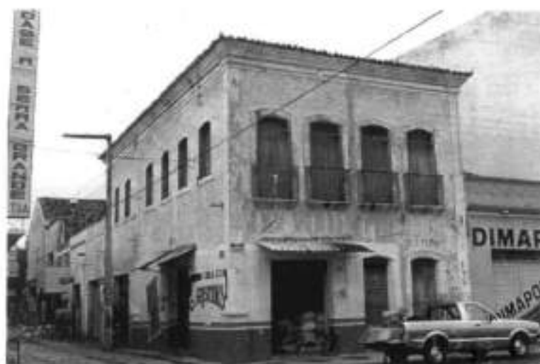
Figura 142 – Degradação de exemplares arquitetônicos de interesse Fotografia Gentil Barreira Fonte: Estudo para Tombamento Federal – ETF/Sobral 1997
