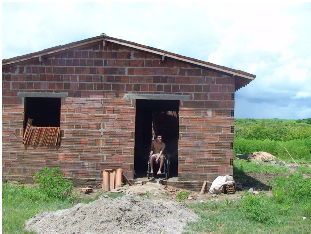
Figura 5 – Júlio na construção da sua nova casa. Ao final da pesquisa de campo, a casa estava concluída e Junior, esposa e filha já moravam no lugar.
