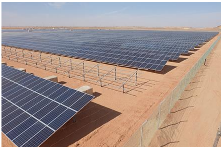
Figura 3 - Instalação de estrutura de fixação fotovoltaica em solo sem uso de tracker
