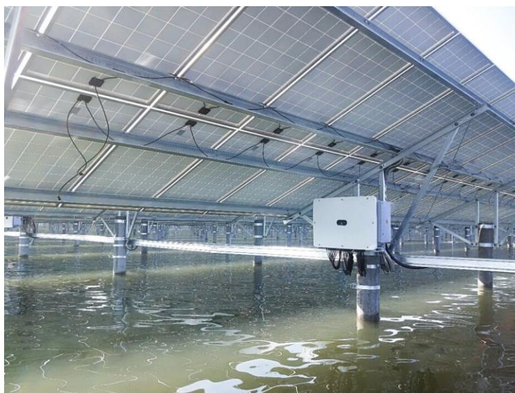
Figura 2 - Aplicação fotovoltaica com o uso de inversores de string
