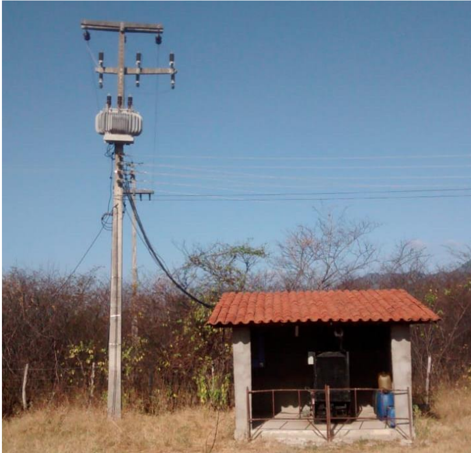
Figura 5- Transformador de 75 Kva e gerador de 150 Kva utilizados pela Fazenda
