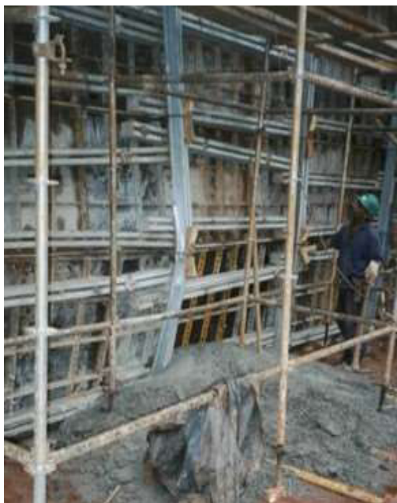
Figura 3 – Exemplo de fôrma mal dimensionada
