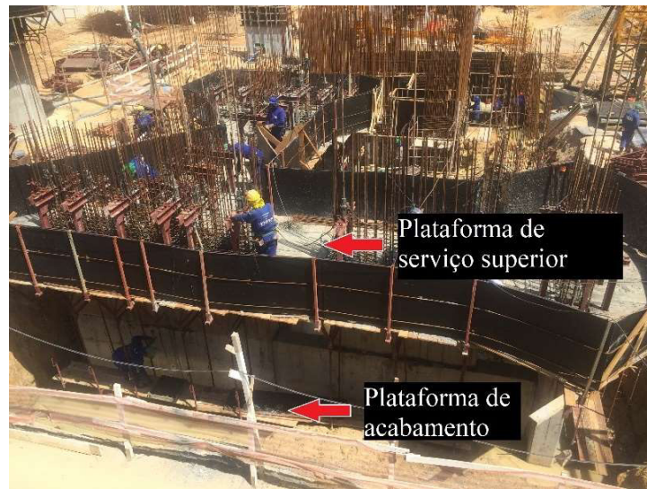
Figura 11 – Identificação das plataformas de serviço
