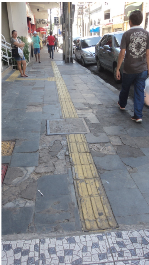
Figura 10: Sinalização Tátil mal executada no Centro de Fortaleza.
