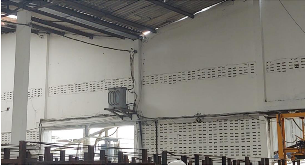
Figura 11 - Transformador em operação grupo B – máquina de blocos
