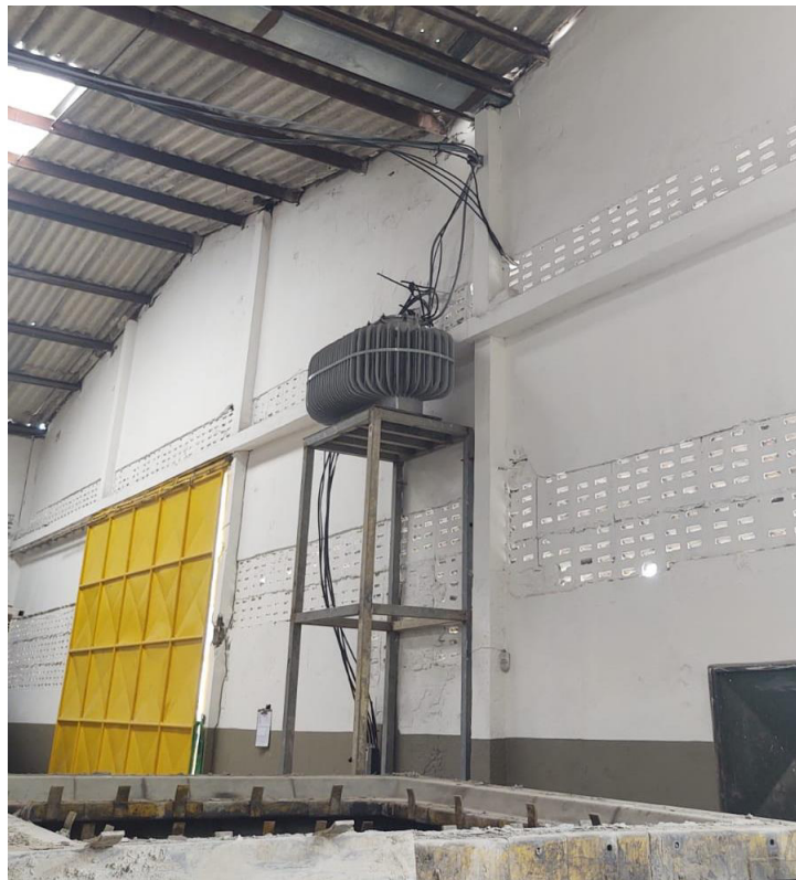
Figura 10 - Transformador não operante grupo B
