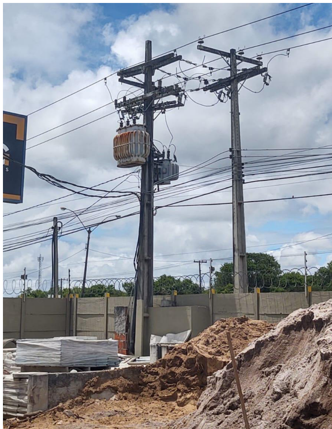
Figura 9 - Transformador de tensão Grupo A
