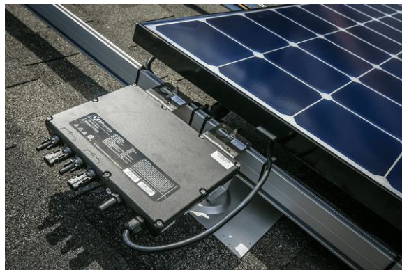
Figura 7 - Exemplo de instalação com micro inversor
