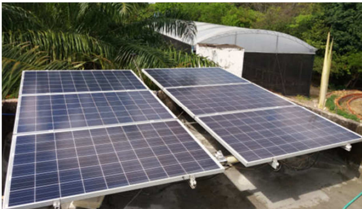
Figura 15: Arranjo FV instalado em telhado no LEA- UFC
