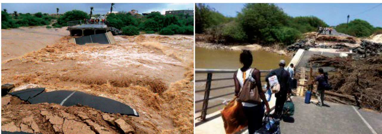
figure 4 et 5 : Effondrement d'un pont sur le fleuve d'Água à Boavista, septembre 2012 1 . 1. www.sapo.cv (26 septembre 2012).
