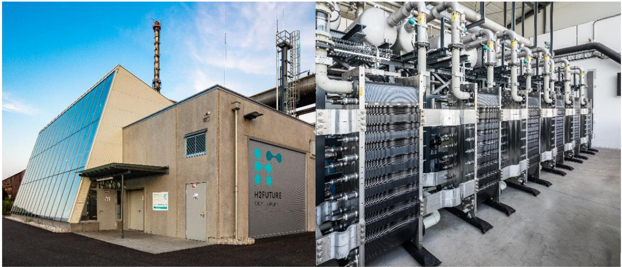
Figura 27 – Estação de Eletrólise instalada.
