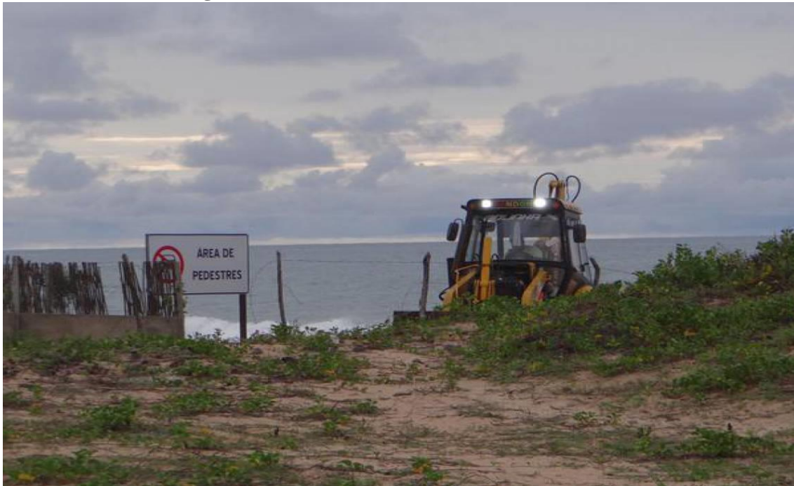
Figura 07: Tratores são usados para destruir os eolianitos das paleodunas Cascudo de Fogo em Icarai de Amontada – CE, dia 27 de abril de 2020
