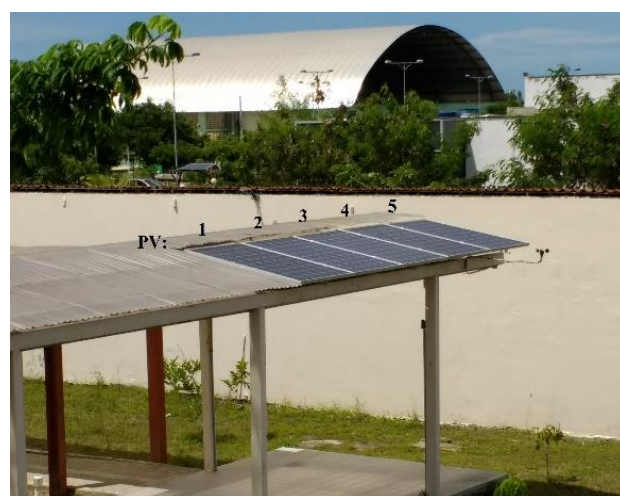
Fig. 2. Maracaná PV plant.
