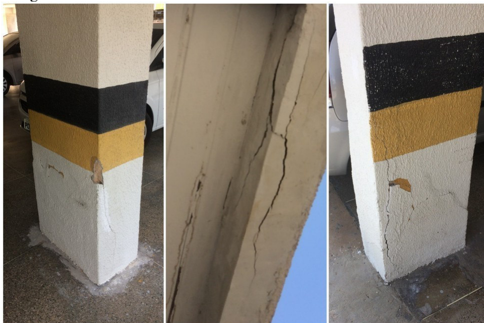
Figura 2 – Pilares antes do desabamento da estrutura do edifício Andrea
