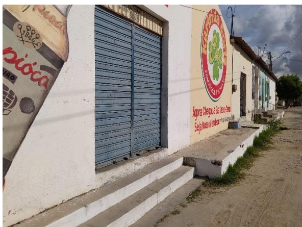
Figura 116 - Calçadas com desníveis 1
