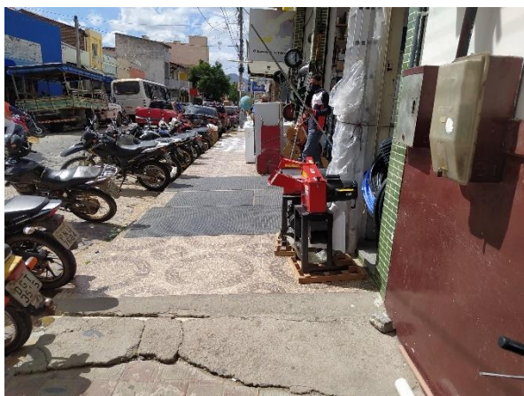
Figura 46 - Calçada com piso danificado
