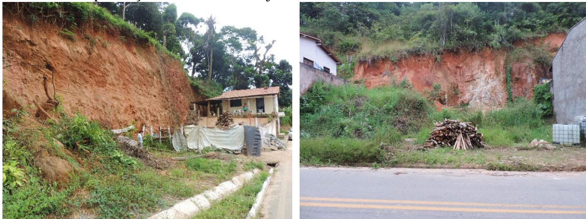
Figura 30 – Casas muito próximas aos cortes de vertentes sem dispositivos de contenção. Identifica-se a presença de solos residuais jovens nas camadas claras.
