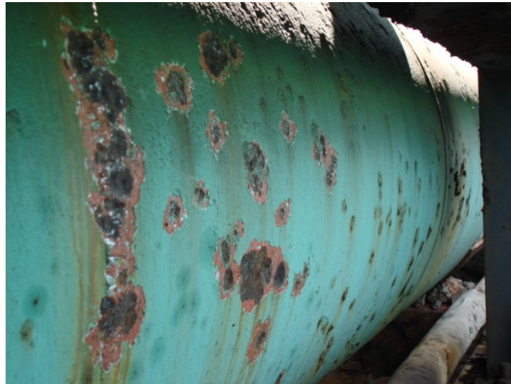
Figura 2 – Defeito típico em dutos industriais, corrosão externa.
