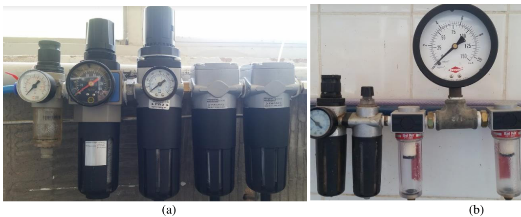
Figura 17 – Filtros e reguladores de pressão.
