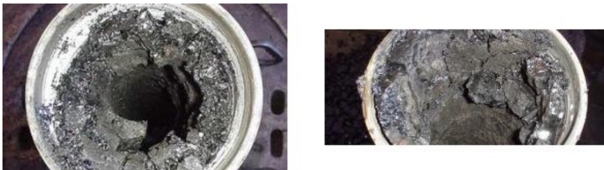
Figura 3 – Depósitos de asfalto numa tubulação
