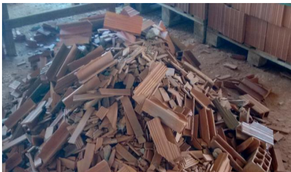
FIGURA 3 - Entulho em excesso na frente de serviço.
