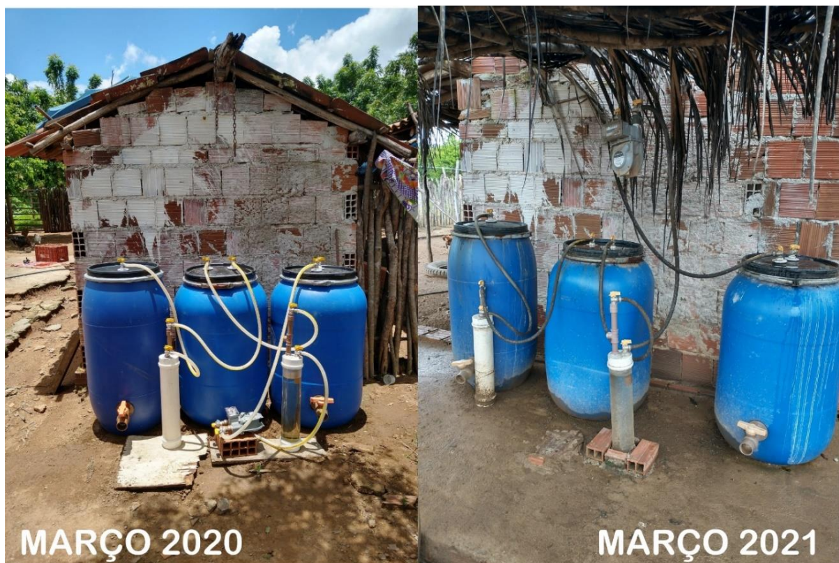
Figura 10 – Protótipo de biodigestor instalado em uma residência rural no município de Forquilha
