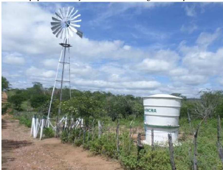
Figura 5 – Equipamentos/Poço artesiano no PA Lagoa do Coiqui – Monte Santo
