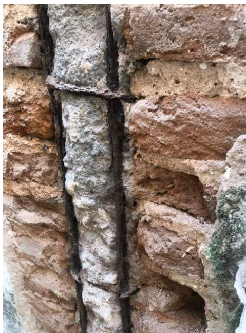
Figura 1 – Corrosão nas armaduras de um pilar
