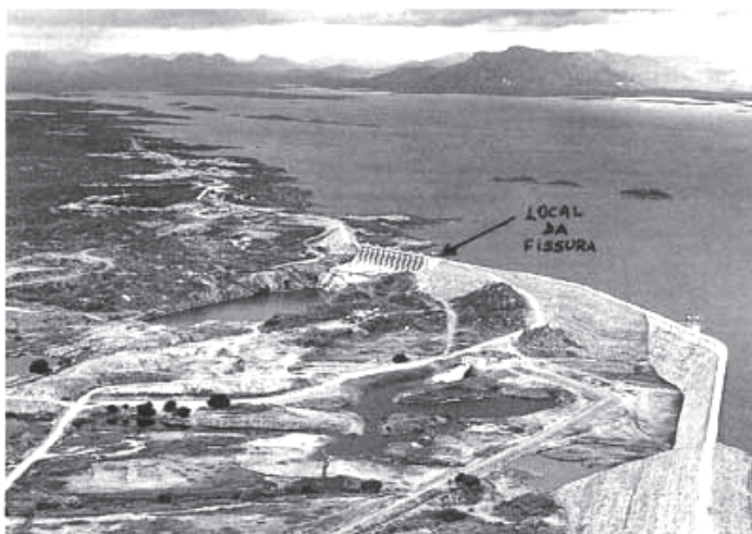
Fig. 6 – Localização da trinca vista de jusante, fonte: DNOCS (2015).
