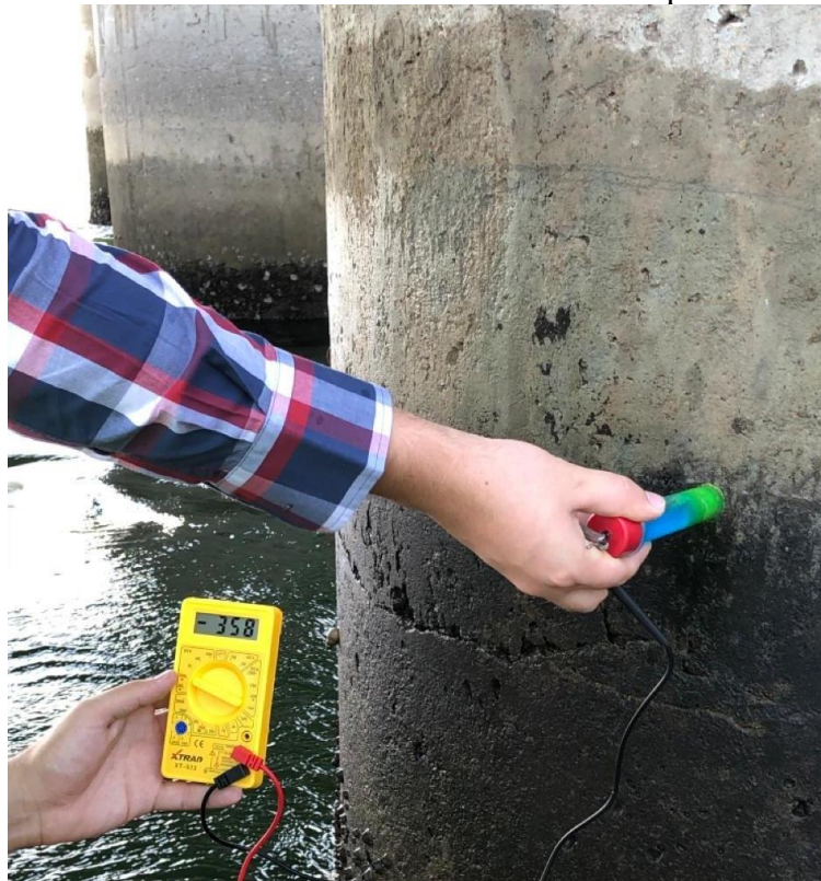
Figura 15 - Eletrodo de referência em contato com a superfície do concreto
