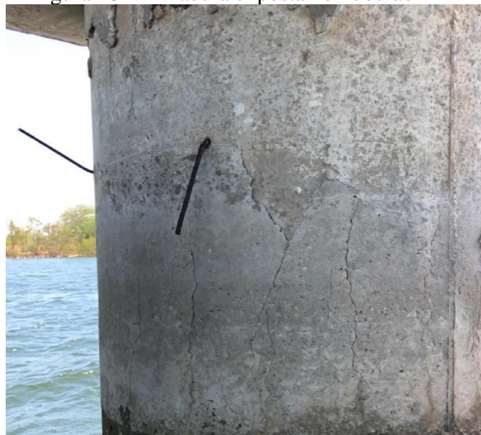
Figura 26 - Armadura exposta no Tubulão T4A
