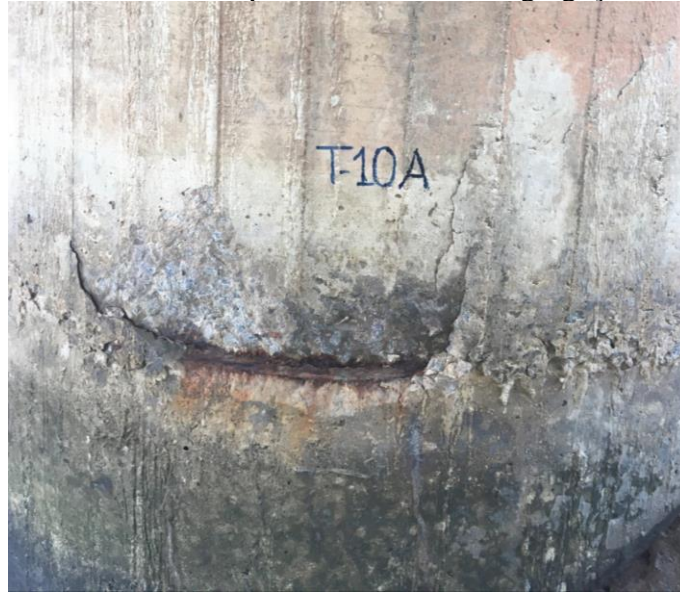
Figura 30 - Armadura exposta e indícios de segregação em T10A
