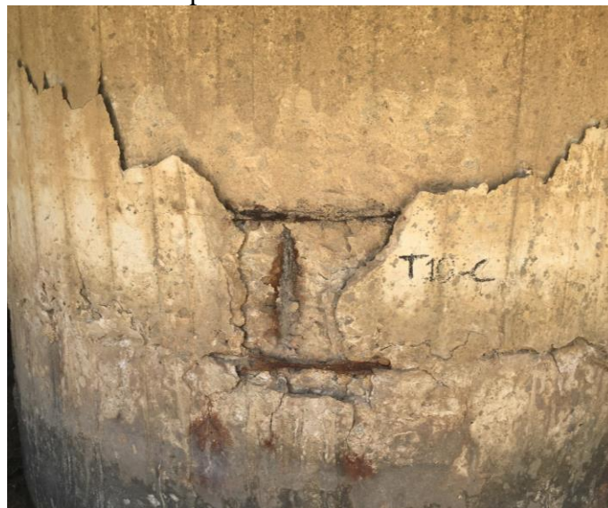
Figura 31 - Armadura exposta e concreto delaminado no tubulão T10C
