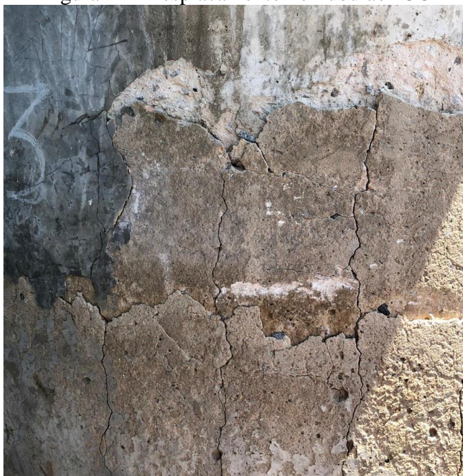
Figura 22 - Deslocamento no Tubulão T3C
