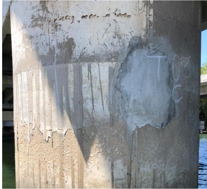
Figura 23 – Indícios de execução inadequada da mistura de concreto no Tubulão T3C
