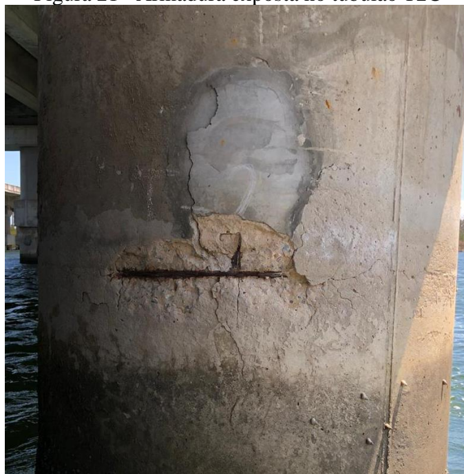
Figura 21 - Armadura exposta no tubulão T2C
