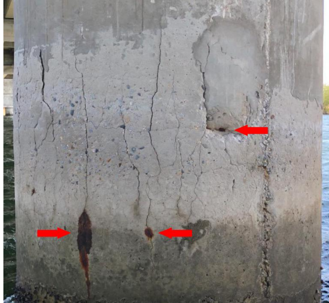
Figura 25 - Fissuras e início de deslocamento no Tubulão T4A
