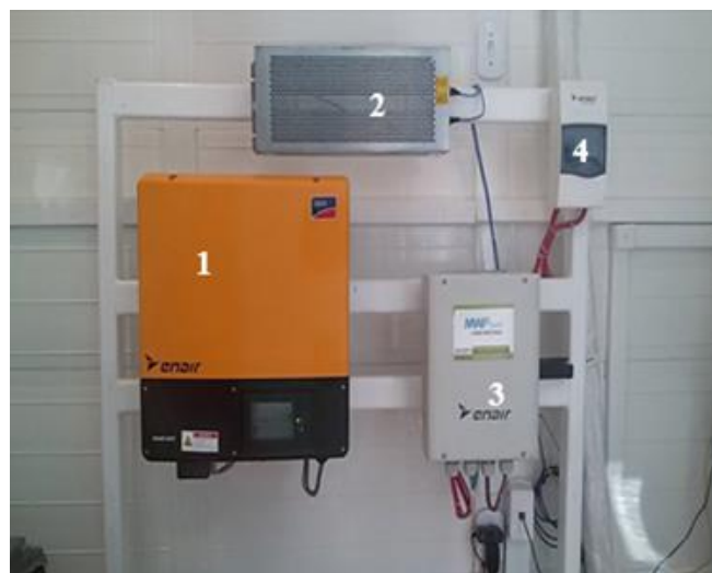
Figura 5 – Inversor Sunny Tripower 5000 TL (1), resistência de dissipação (2), regulador eólico MWPTech Enair (3) e chaveamento de freio (4).
