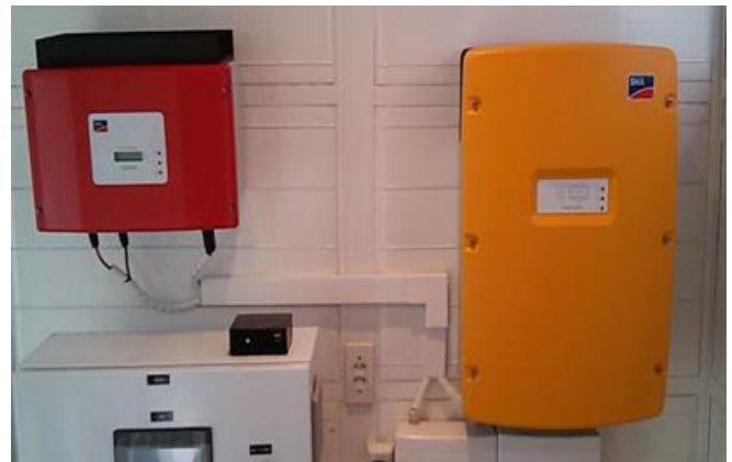
Figura 3 – Inversores Sunny Boy SB2100-TL (vermelho) e Sunny Island 3.0M (amarelo) do sistema fotovoltaicos de potência 2kWp.
