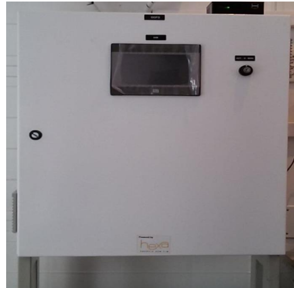
Figura 7 – Quadro Geral de Força e Dados instalado no Laboratório de Testes
