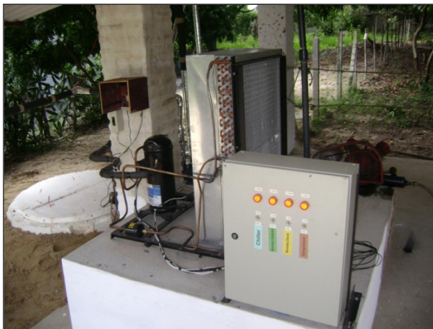
Figura 9. Sistema de refrigeração primário.
