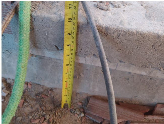
Figura 31 – Diferença de nível entre a laje que sofreu deformação e a laje do restante da casa que foi feita após a deformação da primeira.
