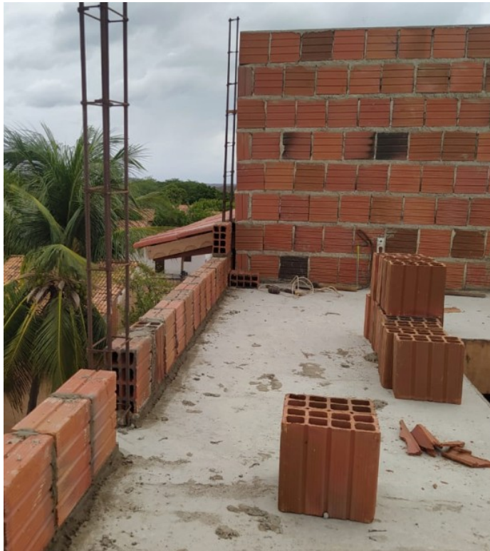
Figura 25 – Sobras dos tijolos.
