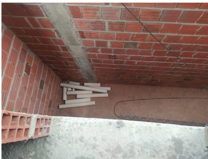
Figura 23 – Sobras de canos das instalações hidráulicas.
