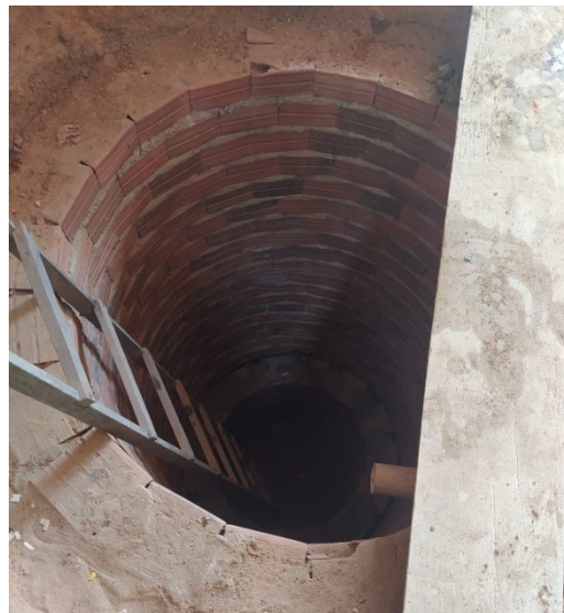
Figura 28 – Fossa sem proteção perto da entrada da garagem.
