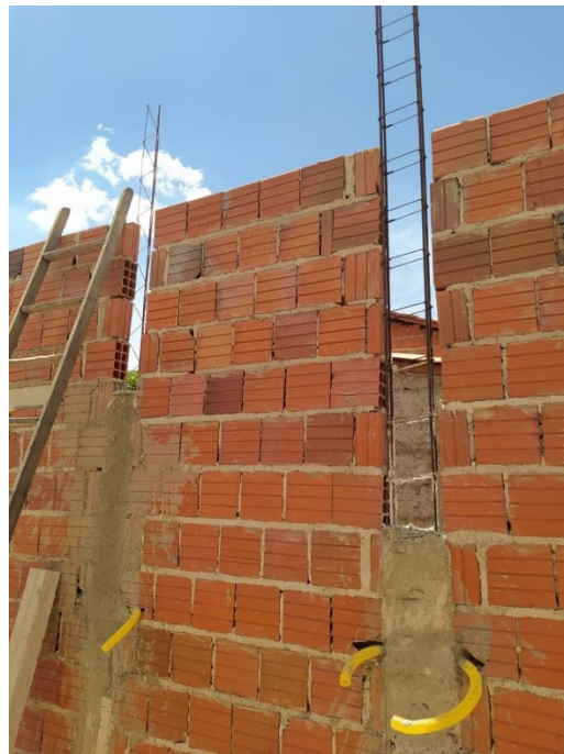
Figura 18 – Armaduras que necessitam de aumento.
