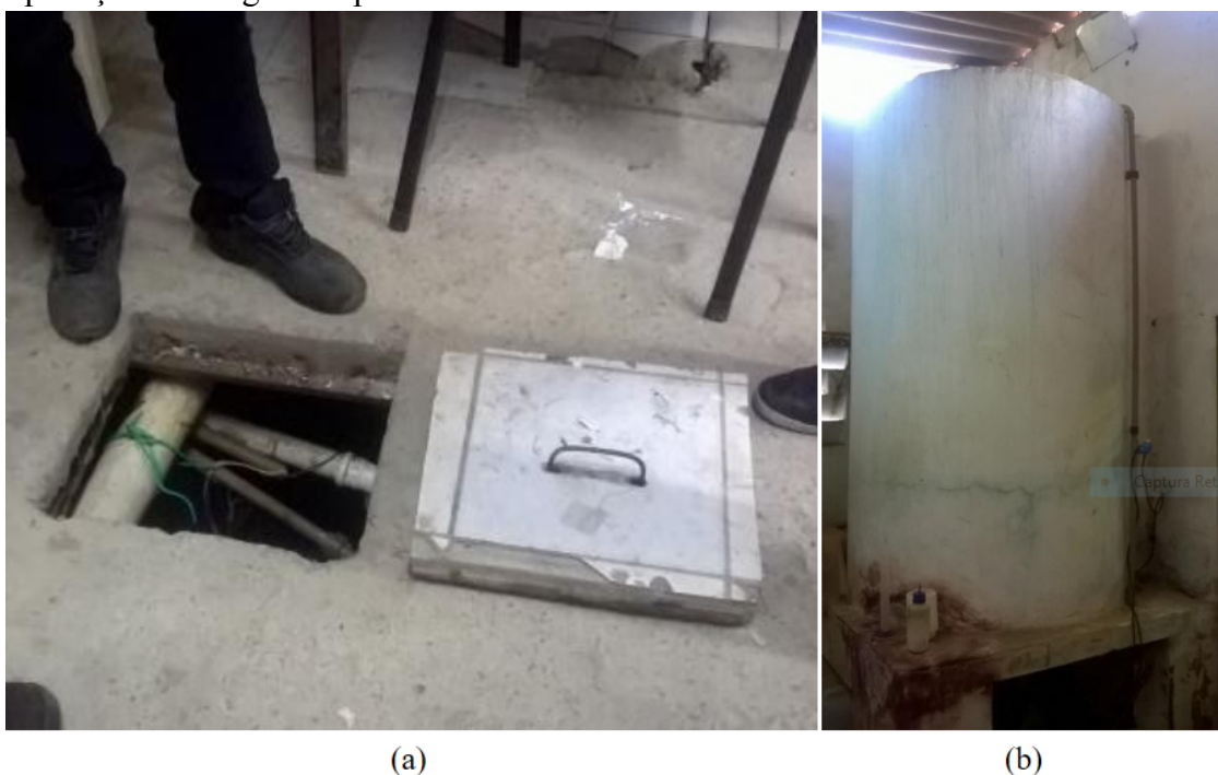
Figura 21 - (a) Imagem da cisterna para equalização dos efluentes; (b) tanque de aplicação do coagulante para tratamento do efluente.
