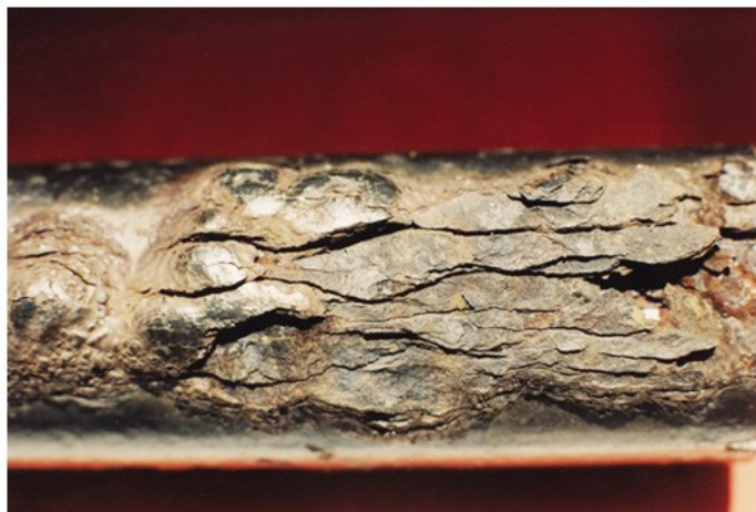
Figura 8 – Corrosão por esfoliação em tubo de aço carbono
