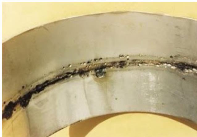
Figura 12 - Corrosão em tubulação de aço inoxidável em torno de cordão de solda
