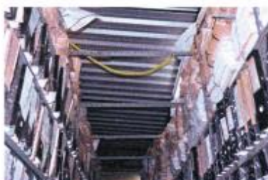
Imag. 19 - Instalações elétrica exposta. Foto: Arlindo Moreira Barreto (Memorial da UFC)
