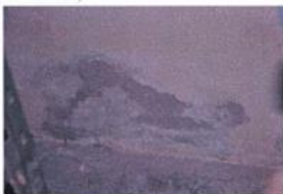
Imag. 18 - Infiltrações. Foto: Arlindo Moreira Barreto (Memorial da UFC)
