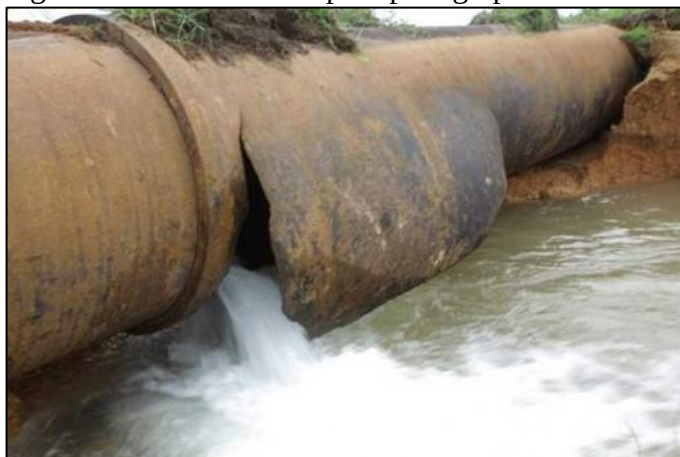
Figura 2.1 - Adutora rompida pelo golpe de aríete
