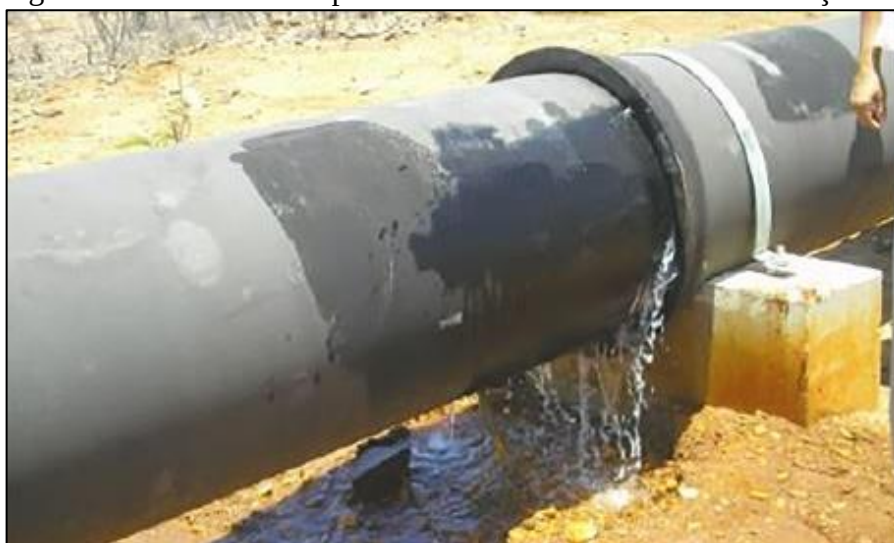
Figura 2.2 - Vazamento típico de deslocamento do anel de vedação
