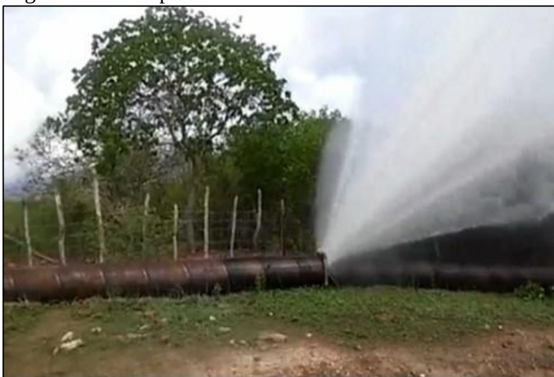
Figura 2.4 - Rompimento e vazamento em uma adutora
