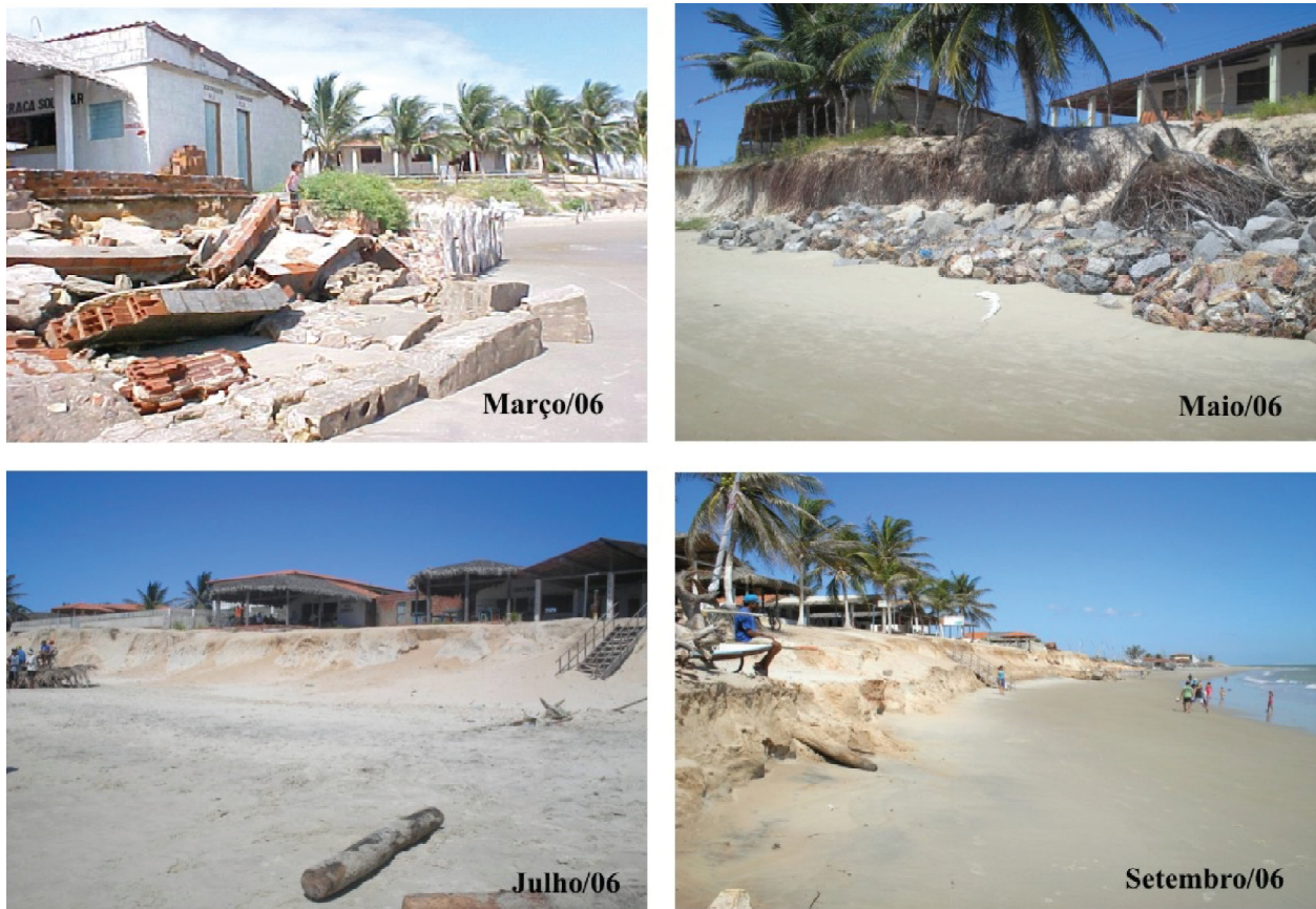
Figura 6- Evidências dos processos erosivos na praia de Pontal de Maceió no ano de 2006. Figure 6 –Erosive process evidences on the Pontal de Maceió beach in 2006
