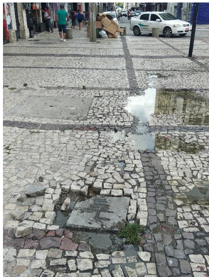
Figura3.59.: Piso irregular, com acúmulo de água e pedras toscas soltas. Fonte: Acervo da autora.
