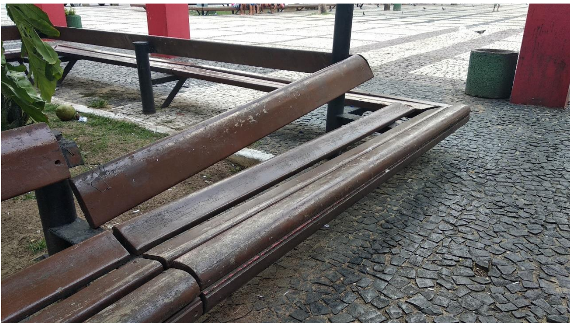
Figura3.63.: Bancos degradados na Praça do Ferreira. Fonte: Acervo da autora.
