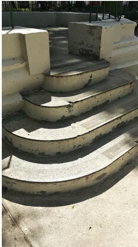
Figura 3.113.: Piso do coreto deteriorado. Fonte: Acervo da autora.
