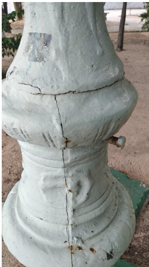
Figura 3.139.: Poste de iluminação deteriorado. Fonte: Acervo da autora.
