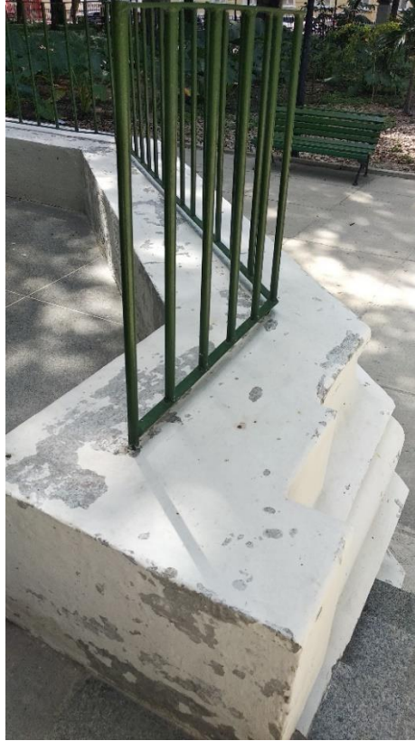
Figura 3.112: Pintura deteriorada e reboco danificado. Fonte: Acervo da autora.
