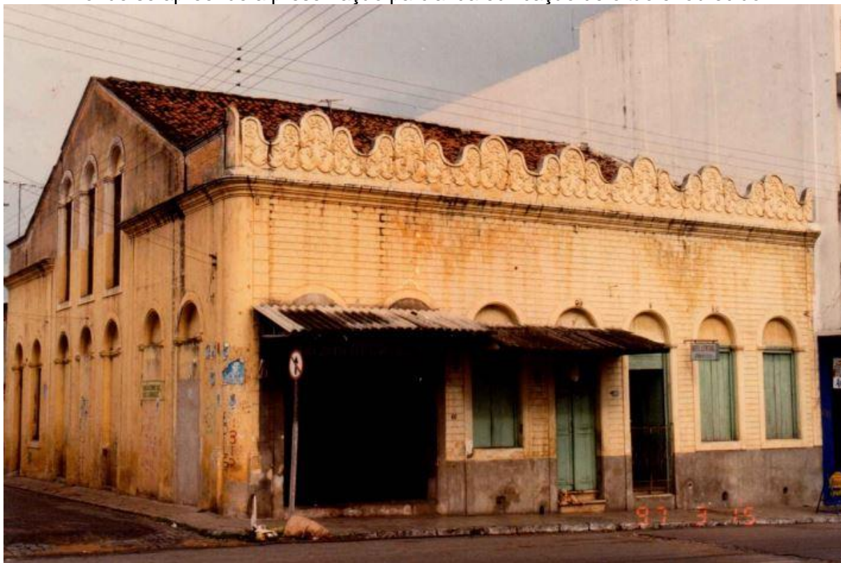
Figura 352 – Imagem da confluência da rua Anahid Andrade com a rua Luzanir Coelho, onde se apreende a preservação parcial da edificação de oitão enobrecido.
