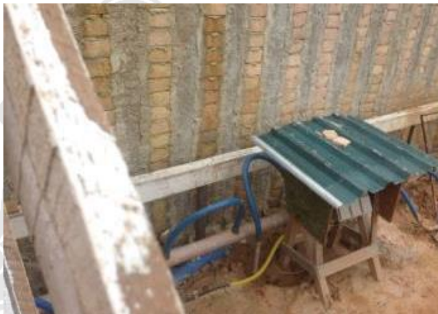
Figura 4 – Tubulação Mac Pipe .
