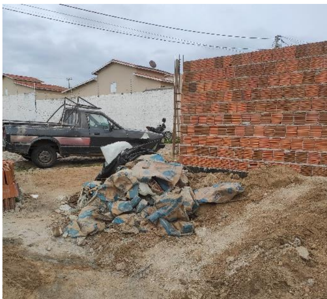
Figura 16 - Pilha de entulhos aguardando retirada da obra.
