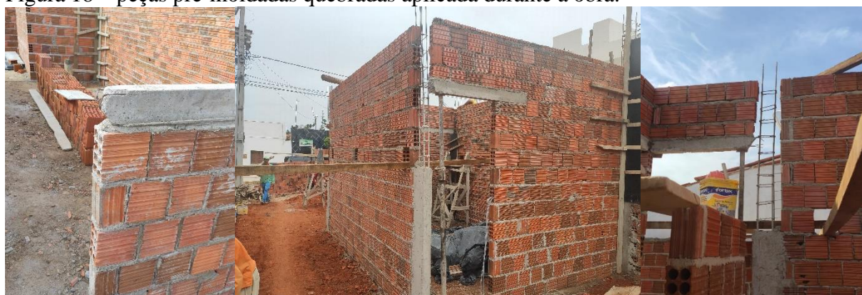
a) contraverga quebrada
