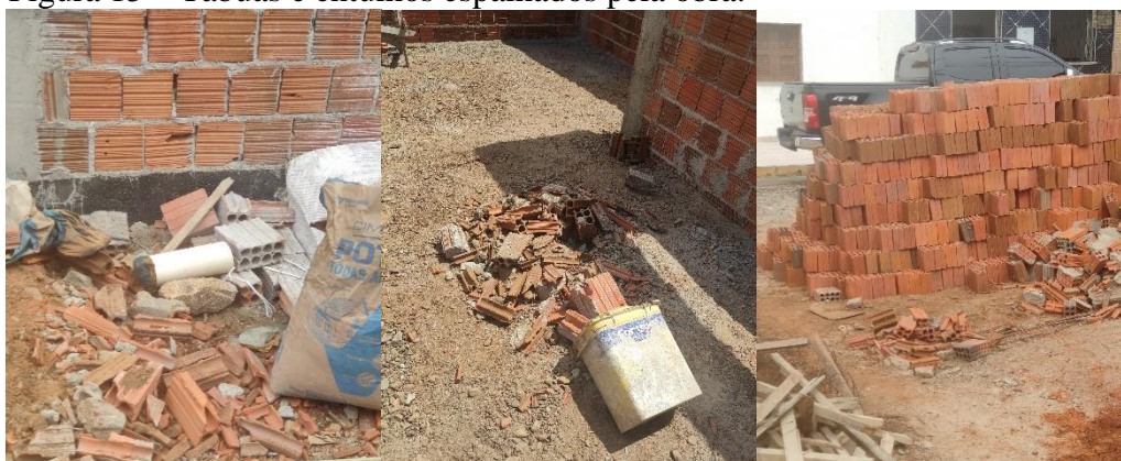
Figura 15 – Tábuas e entulhos espalhados pela obra.
