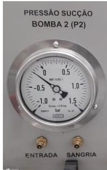
Figura 15 - Manômetro para pressão de sucção com conexão para sangria.
