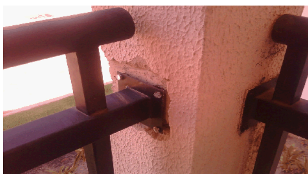
Figura 4 – Baixa qualidade de acabamento de pintura e gradil
