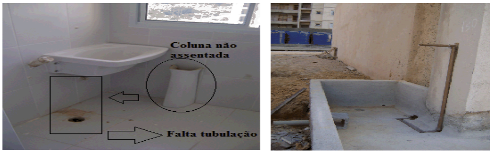
Figura 5 – Falhas de acabamento de reboco, tubulação e louças
