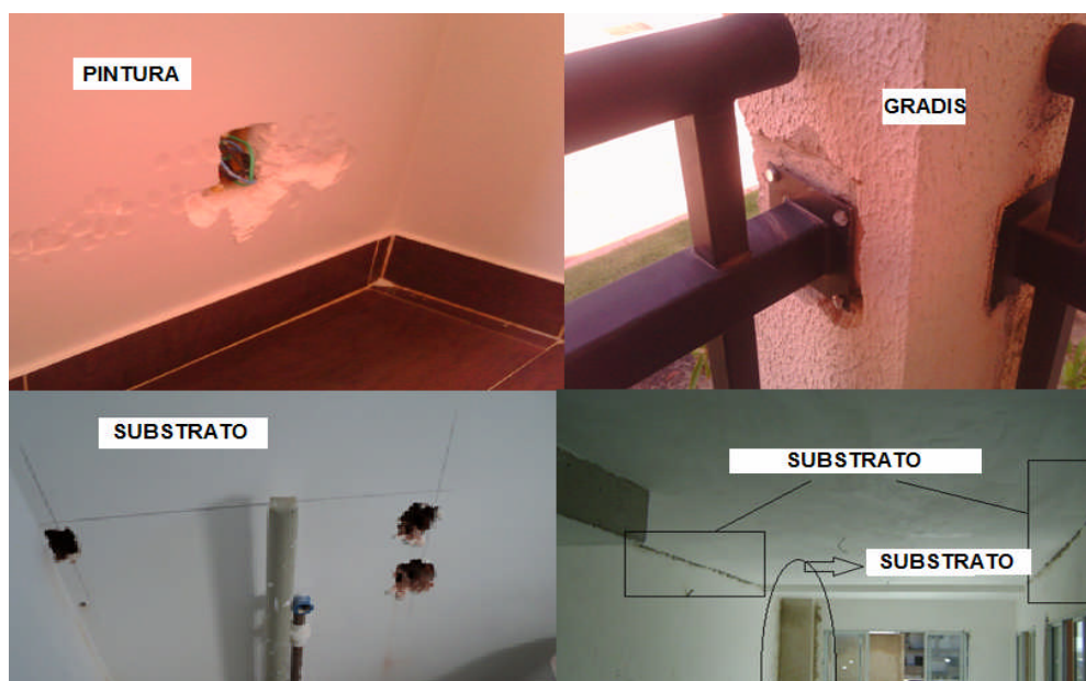
Figura 10 – Registro fotográfico dos problemas e defeitos
