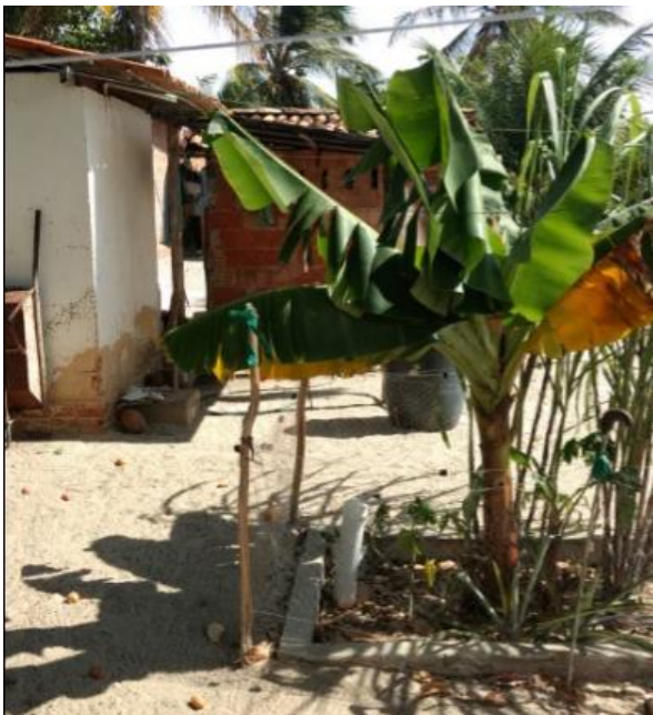
Tipo 1: Fossa conectada diretamente à residência, com bananeira plantada.
