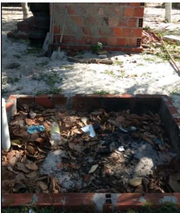
Tipo 2: Fossa conectada diretamente à residência, sem bananeira plantada.
