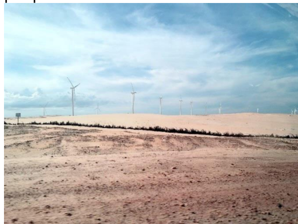
Figura 22 - Estratégia de contenção do avanço das dunas sobre as estradas do parque eólico.
