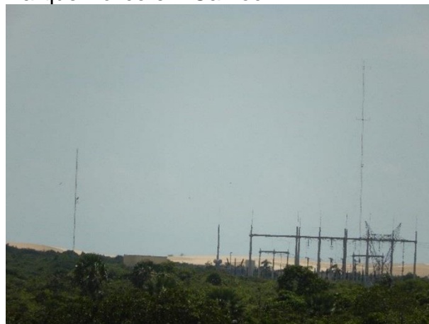
Figura 50 - Subestação vinculada ao Parque Eólico em Camocim.
