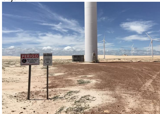
Figura 36 - Placa de sinalização de aerogerador e perigo de risco de queda de objetos.
