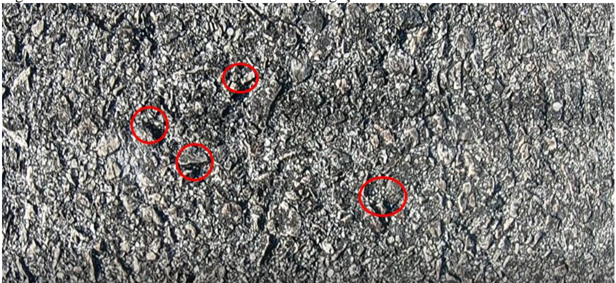
Figura 25 – Revestimento em CAUQ com desagregação
