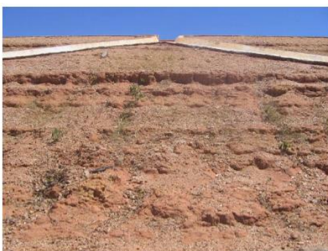
(c) Vista geral das erosões no talude de jusante
