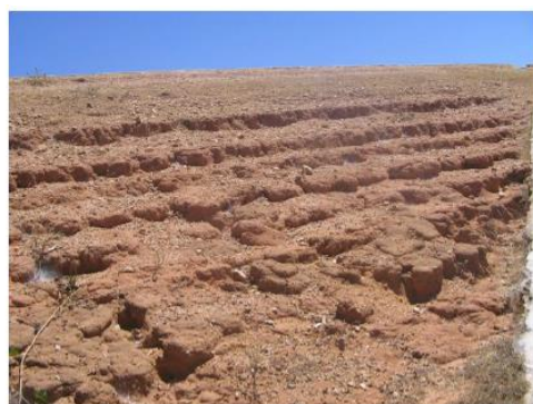
(d) Erosões profundas no talude de jusante
