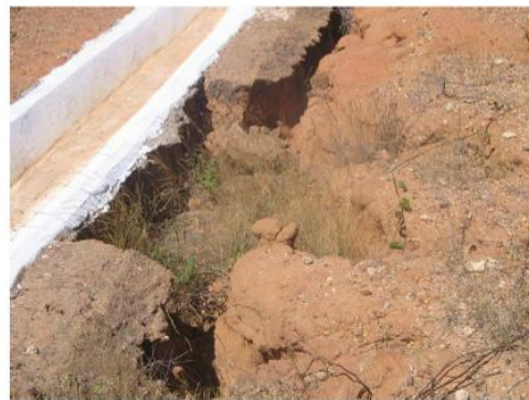
(b) Afundamentos no talude de jusante
