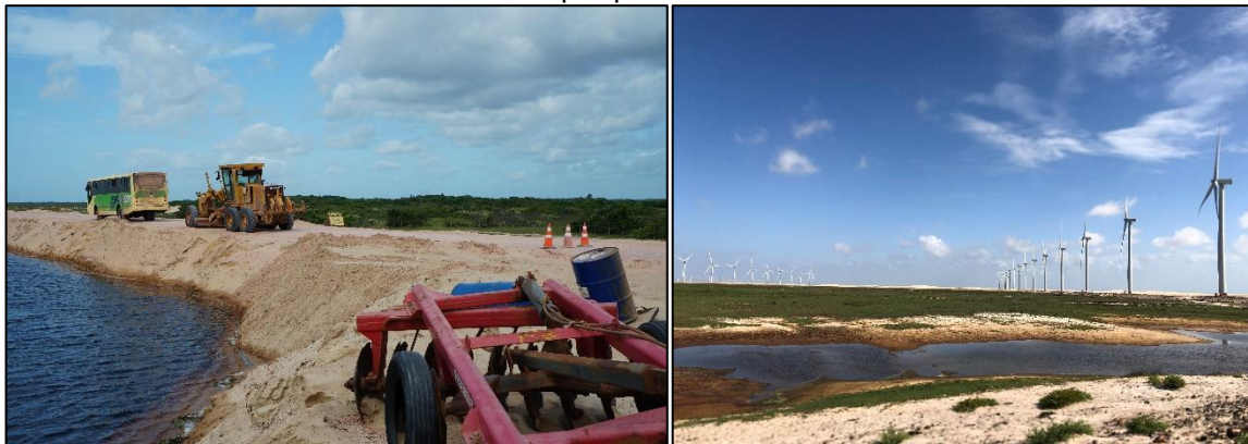
Figuras 19 e 20 – Obra de aterramento para construção dos acessos e lagoas ao longo das turbinas do parque eólico.
