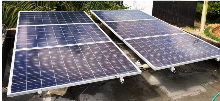
Figura 7 – Planta FV instalada no LEA
