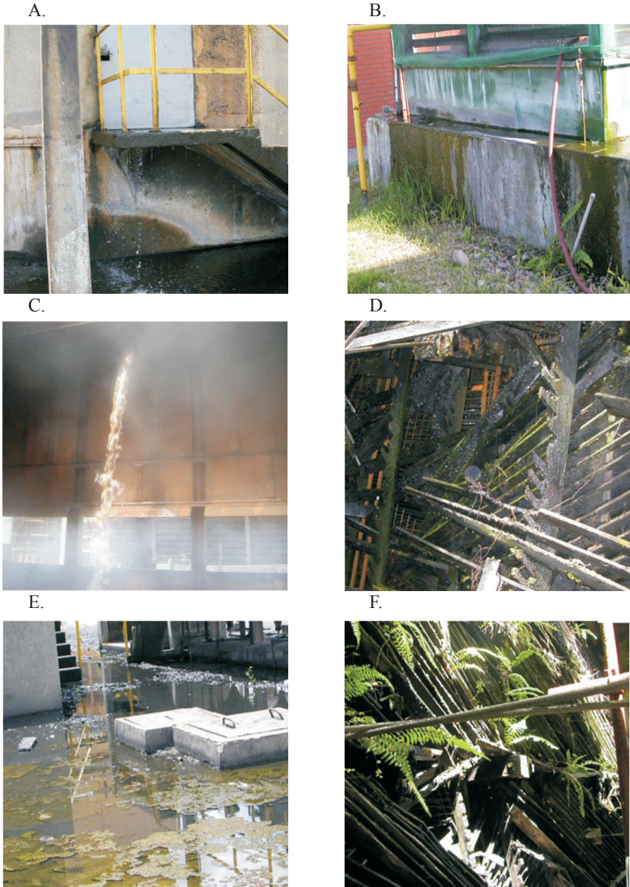
Figura 7.5 Exemplos de perda de água em torre de resfriamento industrial: vazamentos na torre de acesso (A) e na base (B); recheios inexistentes (C) e danificados (D) ocasionando acúmulo de água no pátio (E) e crescimento de plantas (F)
