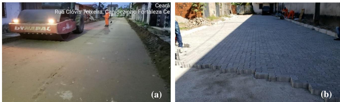
Figura 4: (a) Execução de sub-base e (b) aplicação de camada de assentamento e intertravado
